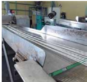
図2. ストランドを精製、切断する装置にカメラを設置。事務所や作業員の持つタブレットで24時間遠隔監視が可能
